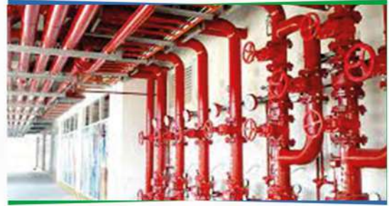
أنظمة الإطفاء الآلي ضد الحريق Automatic fire fighting systems
